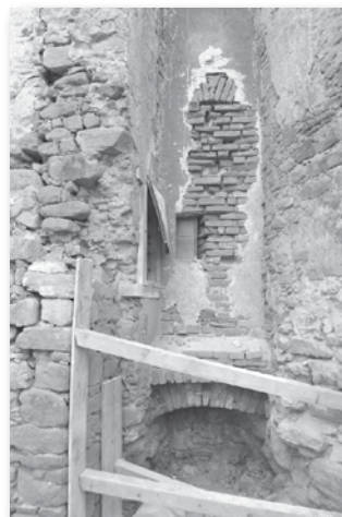
Stěna převetu před opravou
